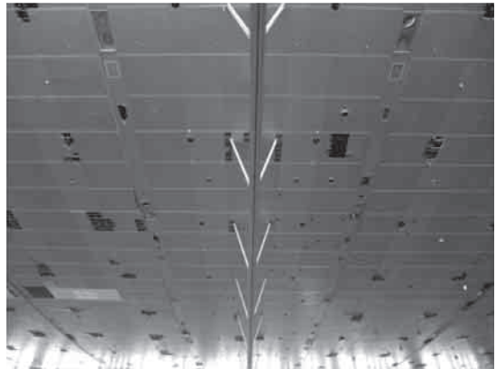
図3 被災後(天井落下)
